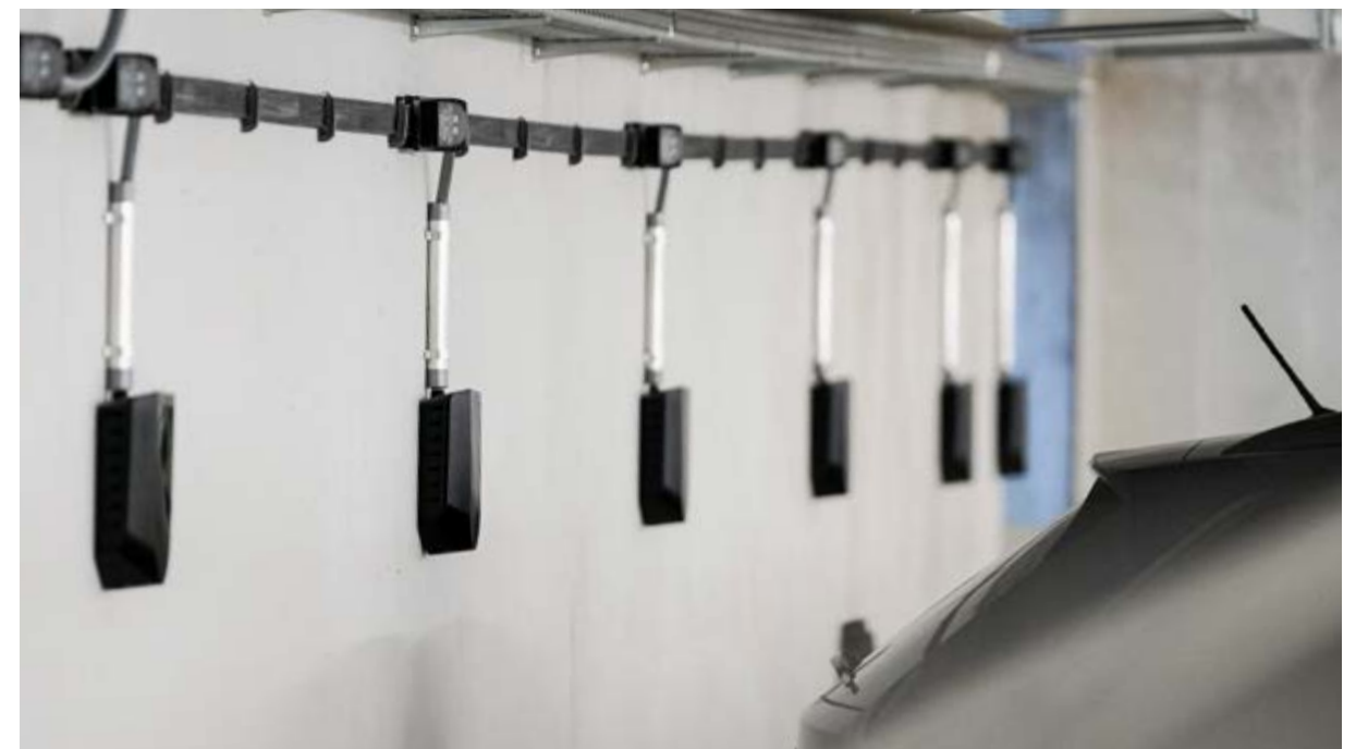
Completo orientamento alla mobilità del futuro: le stazioni di ricarica possono essere ampliate in base alle esigenze.
