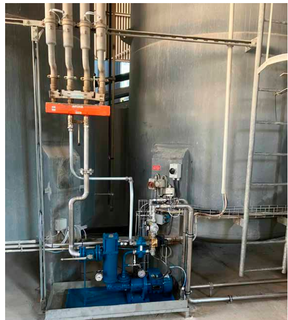
Neue Förderpumpstation mit Entnahmeleitungen der beiden Lagertanks sowie Transferleitungen zu den Brennern.
