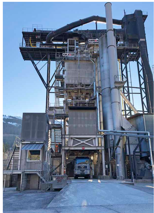
Asphaltanlage mit kompletter Brennstoffversorgung und Bezugsstelle für Flüssigasphalt zur Befüllung der Lkw.
