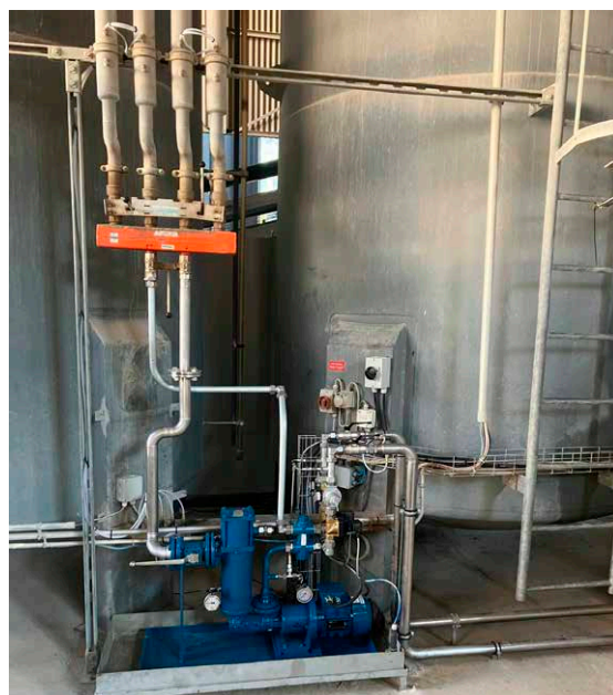
Nouvelle station de pompage avec des conduites de prélèvement des deux citernes et des conduites de transfert vers les brûleurs.
