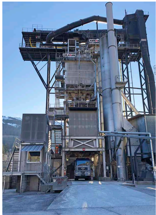
Installation d'asphalte avec alimentation en combustibles complète et point d'approvisionnement pour asphalte liquide pour le chargement des camions.
