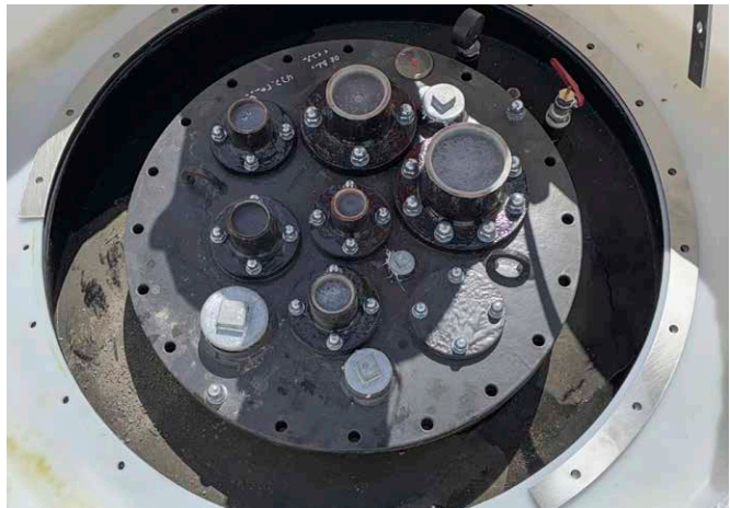
Tankanschlüsse im Domschacht für die spätere Anbindung an die unterirdischen Lagertanks.
