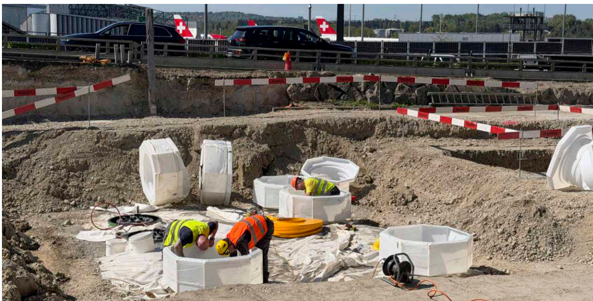
Die Domschächte ermöglichen den Zugang zu Tanks und Rohrleitungsanschlüssen.
