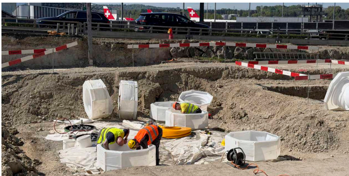
Les chambres étanches permettent l'accès aux citernes et aux raccords des conduites.
