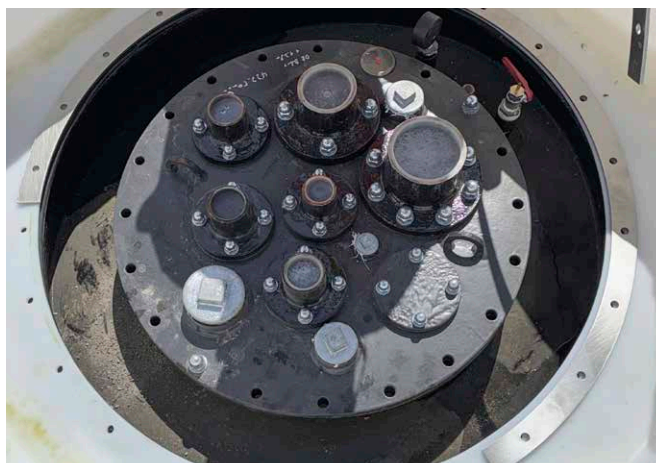
Raccords de citernes dans la chambre étanche, destinés au raccordement ultérieur aux citernes souterraines.
