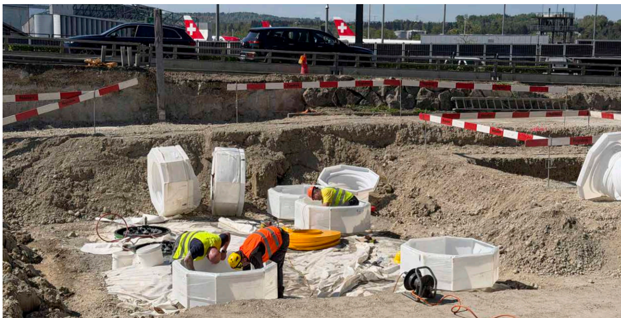
I pozzetti danno accesso ai serbatoi e ai raccordi delle condutture.
