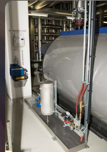
Anlagenkonstruktion mit Auffangwanne.
