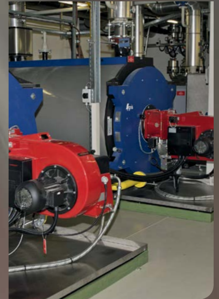
Zwei Heizkessel für Erdgas und Öl.
