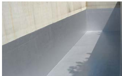
Bassin de rétention de 200 m 3 pour la citerne principale
