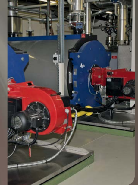
Deux chaudières pour le gaz naturel et le mazout.
