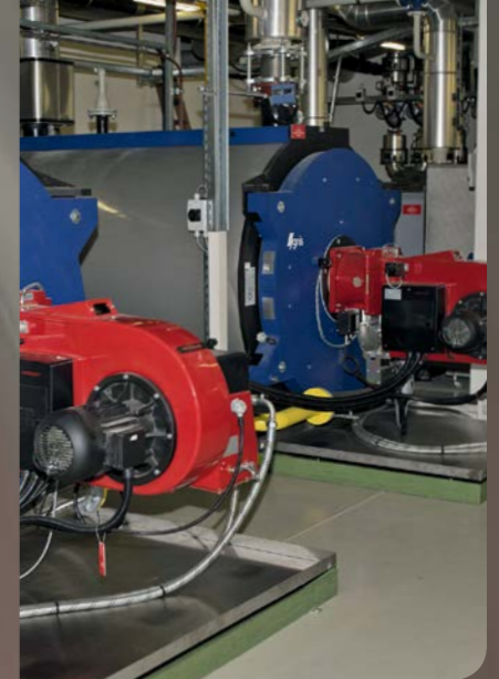
Due caldaie per gas naturale e olio.
