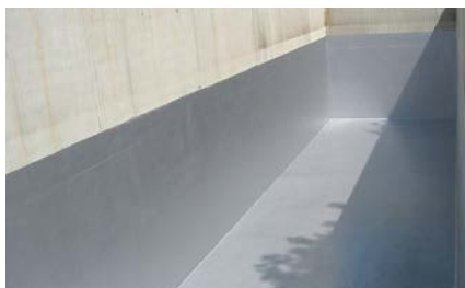
Vasca di raccolta da 200 m 3 per il serbatoio principale
