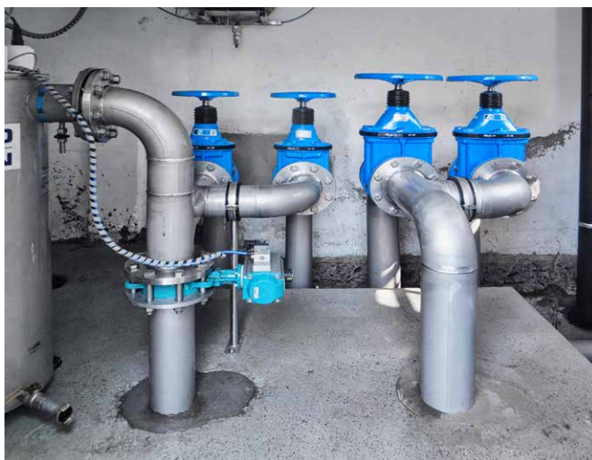
Conduite d'arrivée de source dans l'installation UV
